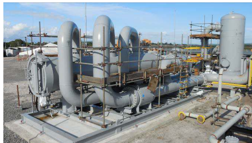
Detalhe de um dos Compressores
