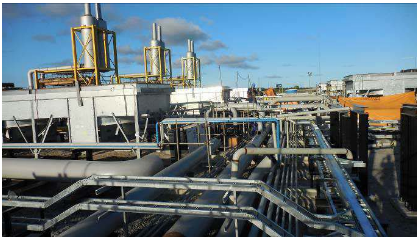
Vista da Planta de Compressão de Manati
