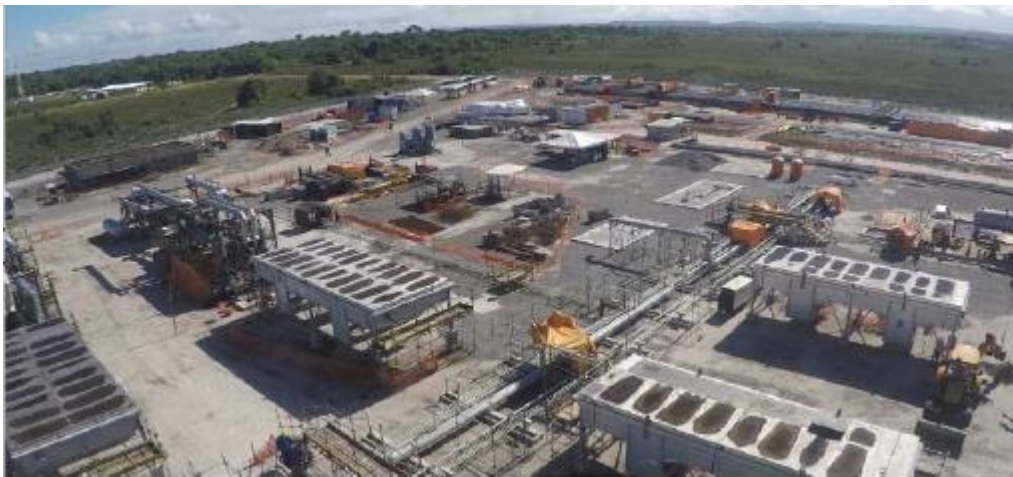
Visão geral da Planta de Compressão do Campo de Manati
