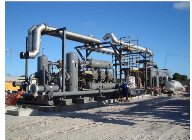
Detalhes do compressor
